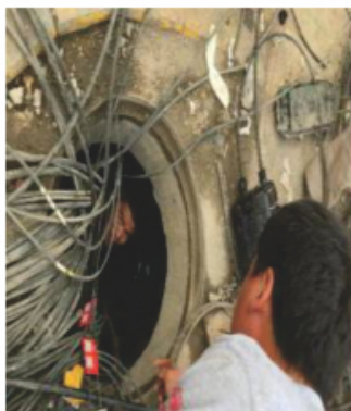
地下人井 管线混乱
